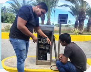
Mantenimiento a equipos de acceso
